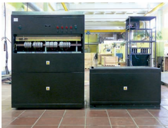
ТФ-Т-40-42-Б — трансфильтр трехфазный мощностью 40 кВА, имеет на выходе 42 направлений (для удобства транспортировки и монтажа разделен на два модуля)
