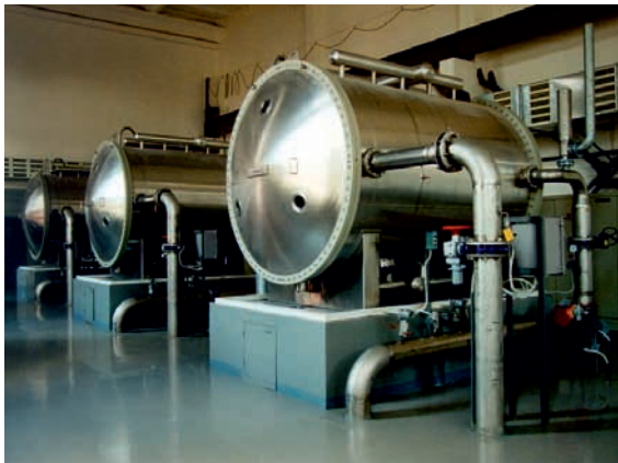
Рублевская станция водоподготовки
